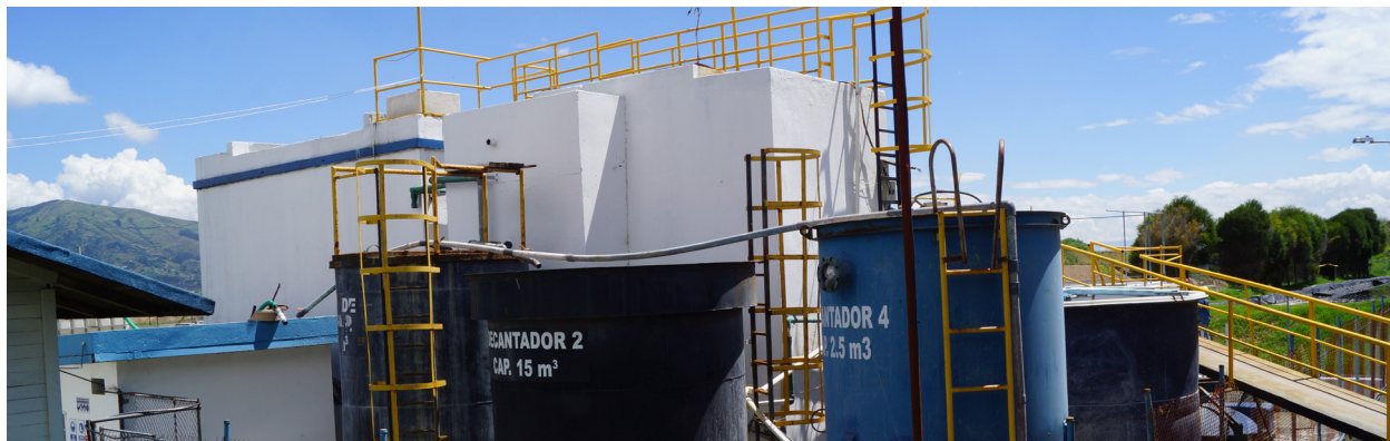
Infraestructura. Planta de tratamiento PTL (tratamiento físico químico y biológico)
