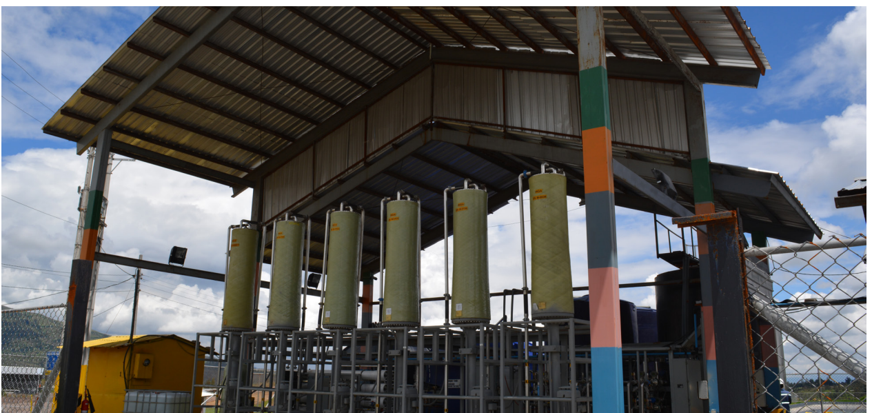
Filtros. Planta de Tratamiento Físico para Lixiviados
